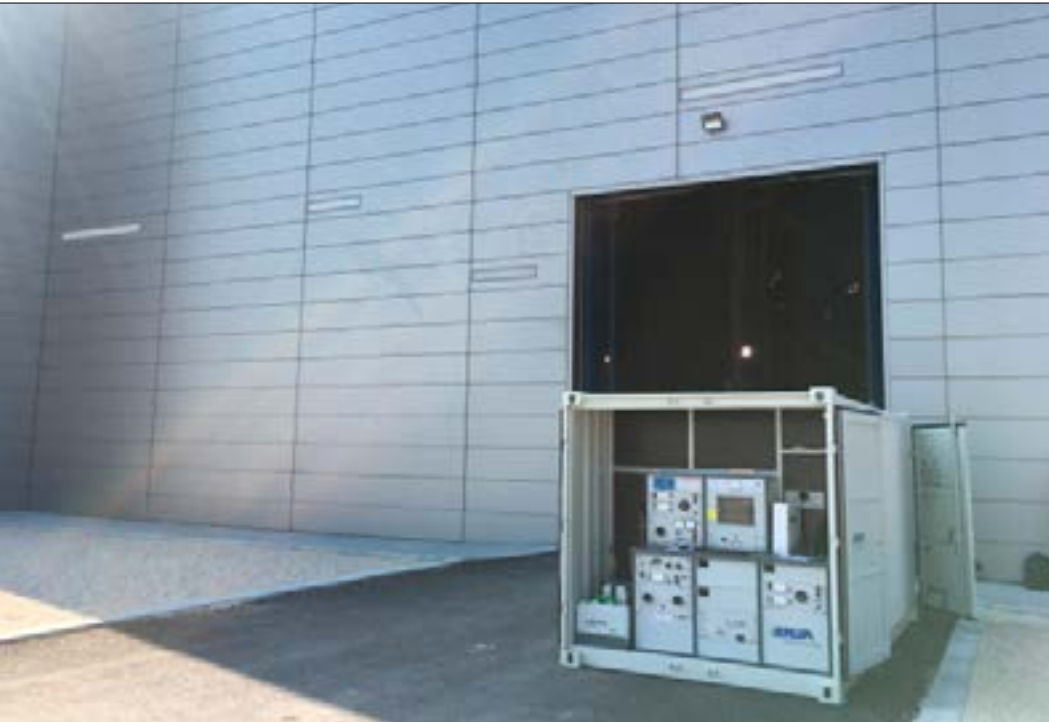
Conteneur de la salle des câbles
