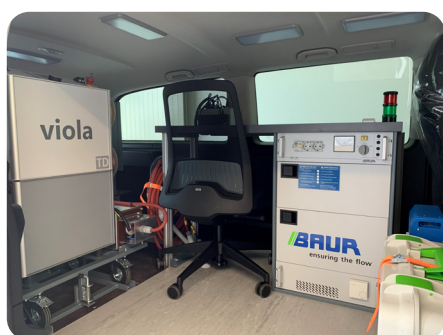
BAUR ha instalado todo lo necesario para el ensayo y diagnóstico de cables de media tensión en una furgoneta eléctrica para SIG.
