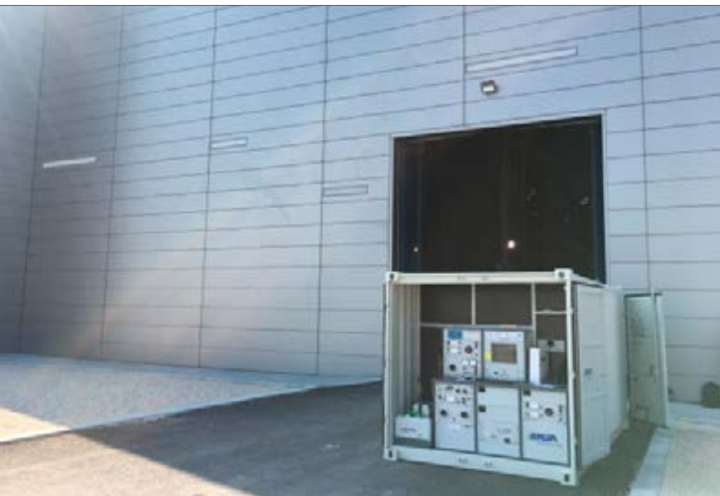
Container di misura davanti al capannone cavi
