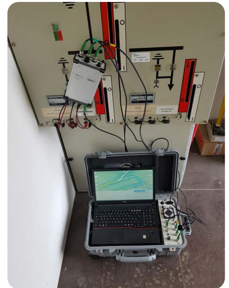
Подключение под рабочим напряжением, измерение под рабочим напряжением: датчик VDS-C позволяет быстро и просто регистрировать частичные разряды на находящихся под рабочим напряжением кабелях.
