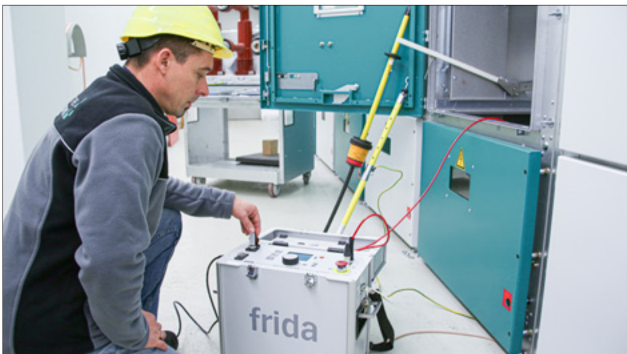
Abbildung 1. Mit kompakten und transportablen Geräten wie frida TD lässt sich die \tan\delta -Diagnose durchführen. Asset-Manager erhalten so wichtige Daten, um die Restlebensdauer von Kabeln zu bestimmen
