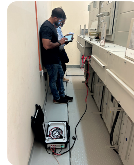
使用 BAUR IRG 400 portable 便携式脉冲反射测试仪进行测量
