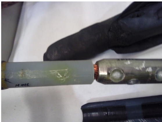
Abbildung 9 Zerlegung der Muffe von Kabel #1, L1 bei 350 m, TE-Kriechspur
