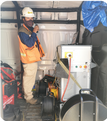
VLF-Prüfsystem PHG 80 portable von BAUR
